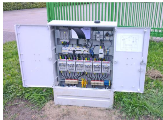
Rys. 3. Szafa oświetleniowa wyposażona w sterownik centralny
